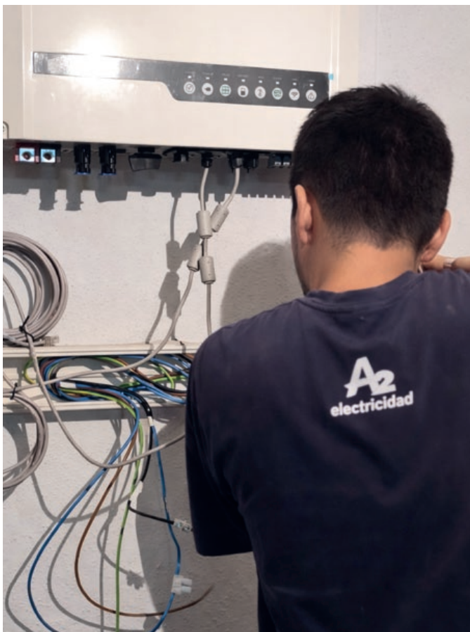
A2 Electricidad se ha especializado en la instalación de puntos de recarga para vehículo eléctrico.
